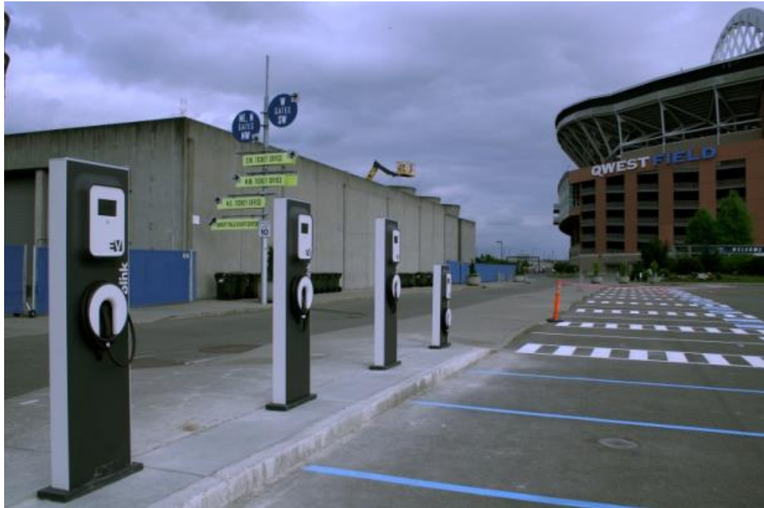
Εικόνα 12. Δημόσιος σταθμός φόρτισης εναλλασσόμενου ρεύματος επιπέδου 2 (Πηγή: Briones et al., 2012).
