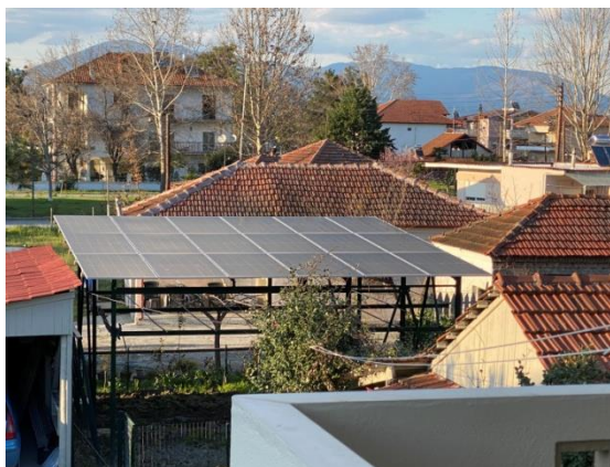
ΕΙΚΟΝΑ 21: ΦΩΤΟΒΟΛΤΑΪΚΑ (ΣΤΕΓΗΣ) 10KW ΕΠΙ ΔΟΜΙΚΩΝ ΣΤΟΙΧΕΙΩΝ(ΠΕΡΓΚΟΛΑ ΚΑΤΑ ΠΑΡΑΓΕΛΙΑ ΓΙΑ ΤΗΝ ΤΟΠΟΘΕΤΗΣΗ ΤΩΝ Φ/Β)
