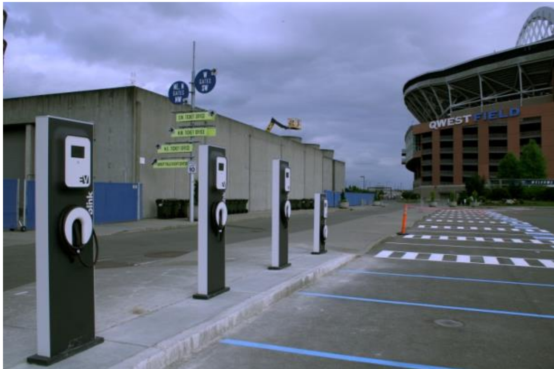
Εικόνα 10. Δημόσιος σταθμός φόρτισης εναλλασσόμενου ρεύματος επιπέδου 2 (Πηγή: Briones et al., 2012).
