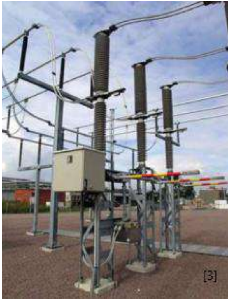
Εικόνα 12: Διακόπτης Ισχύος, Αποζεύκτες και Γειωτές
