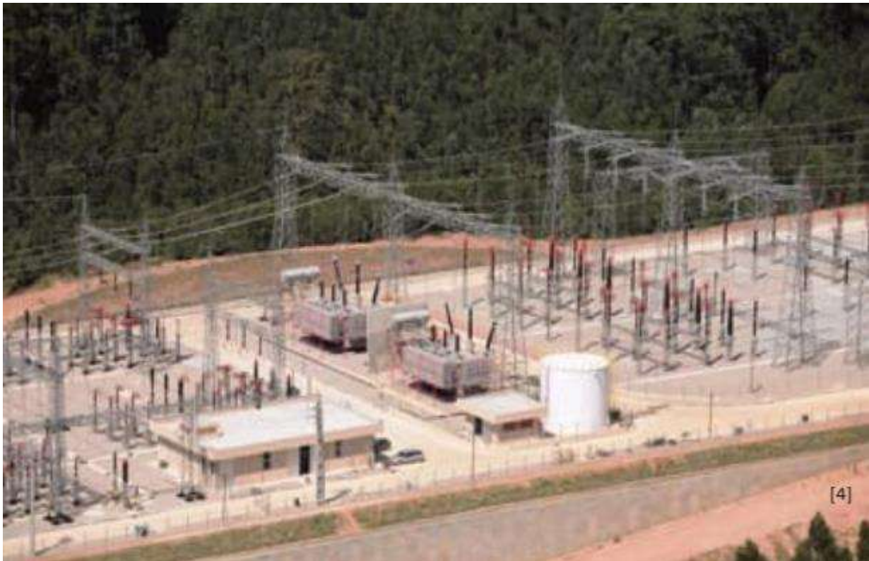
Εικόνα 3: Υποσταθμός με μόνωση αέρα (AIS)
