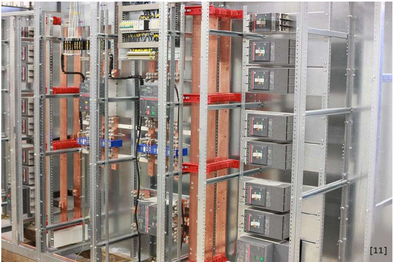
Εικόνα 14: Ζυγοί σε υποσταθμό (ταινία)
