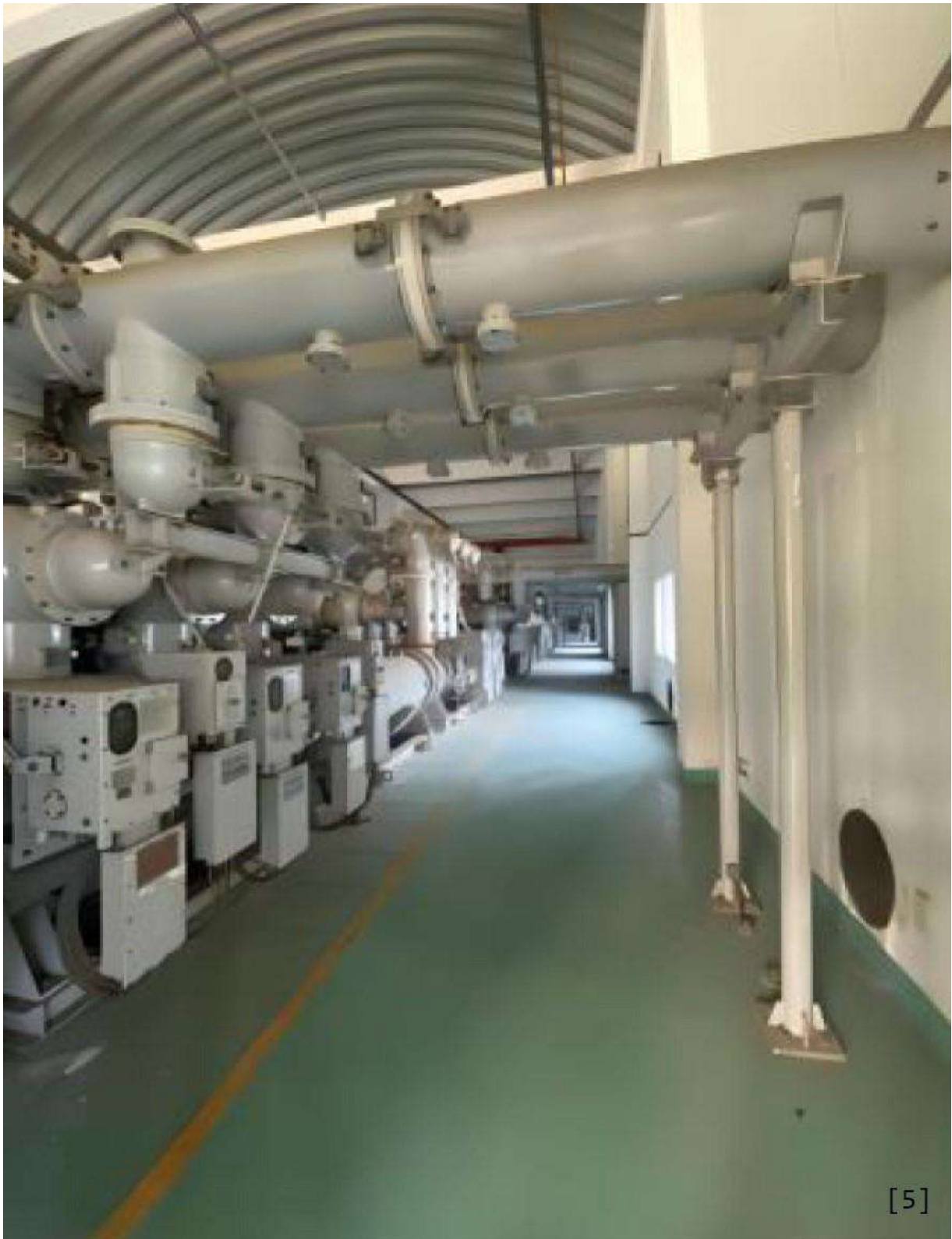
Εικόνα 4: Εσωτερικός υποσταθμός με μόνωση αερίου (GIS)
