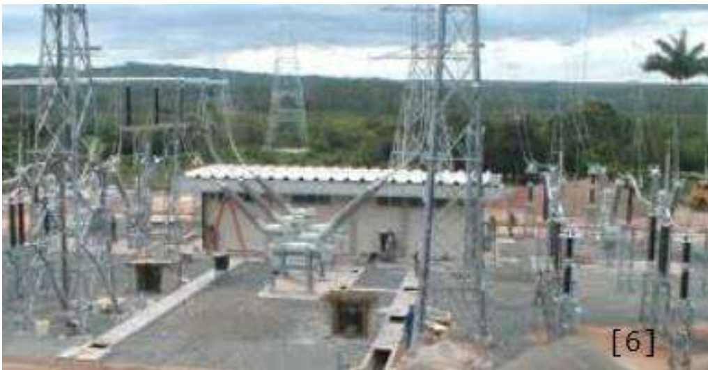
Εικόνα 5: Υποσταθμός με μικτή μόνωση (MTS)
