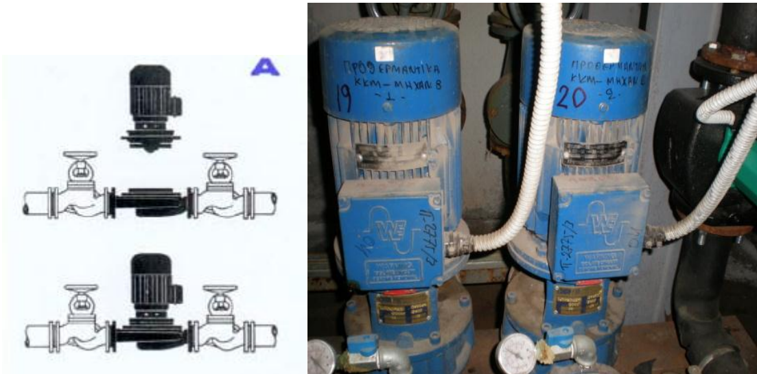
Σχήμα 2.18 : Τοποθέτηση αντλίας (αριστερά), αντλίες νερού θέρμανσης τύπου Drakos Polemis για τα προθερμαντικά στοιχεία των ΚΚΜ του νοσοκομείου (δεξιά).
