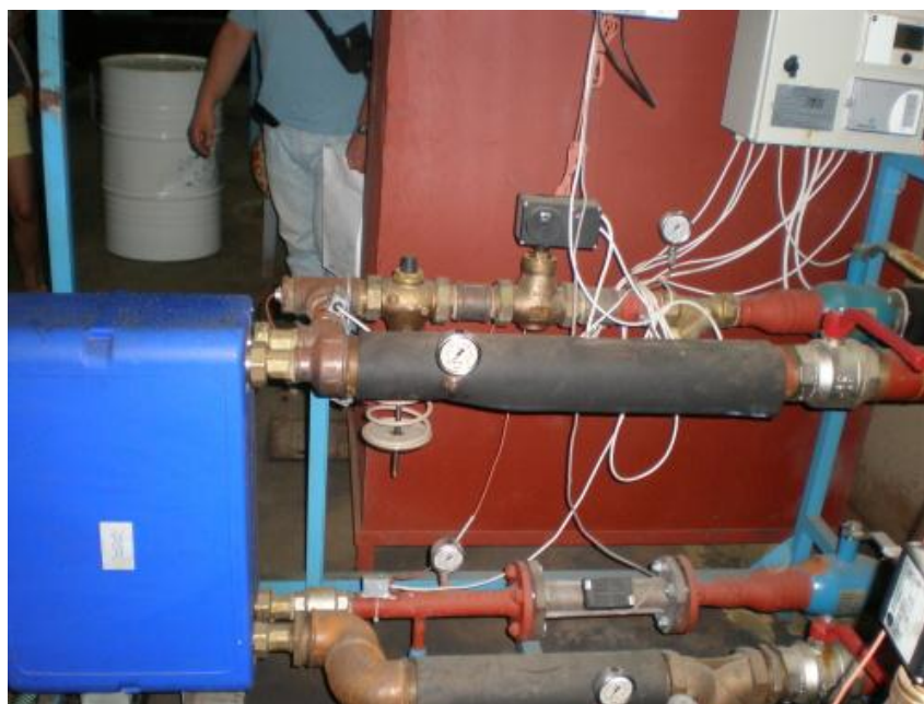
Σχήμα 2.9 : Θερμικός υποσταθμός KQ450
