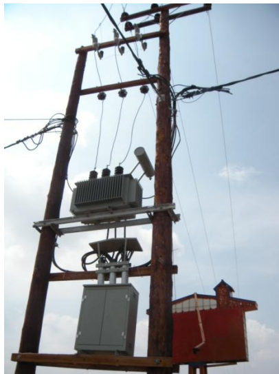
Φωτογραφία 4.10 Δίστυλος Υποσταθμός
