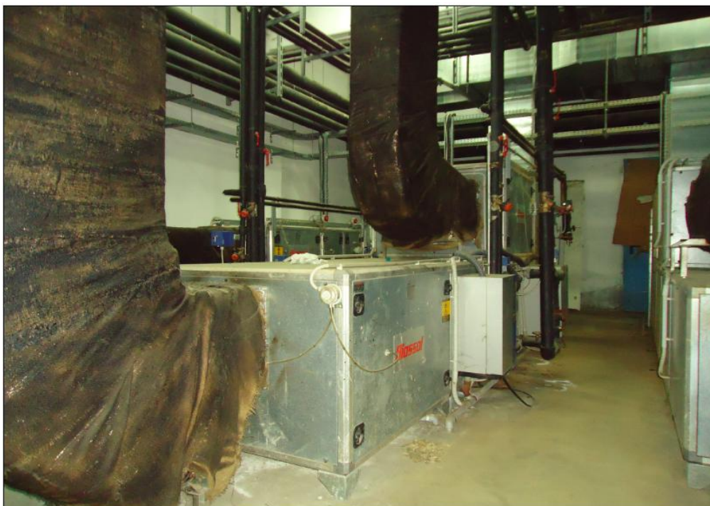
Εικόνα 6.10: Κεντρική κλιματιστική μονάδα
