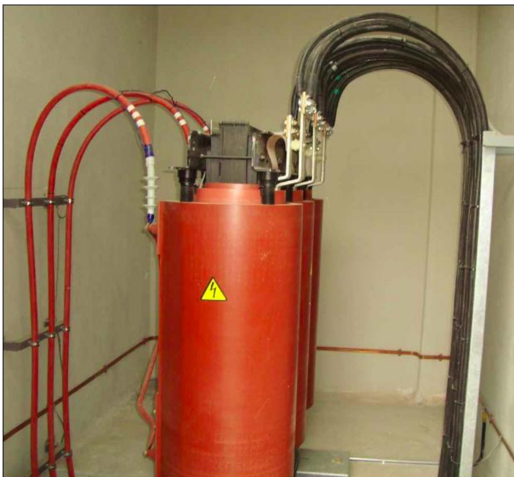
Εικόνα 4.4: Μετασχηματιστής μέσης τάσης
