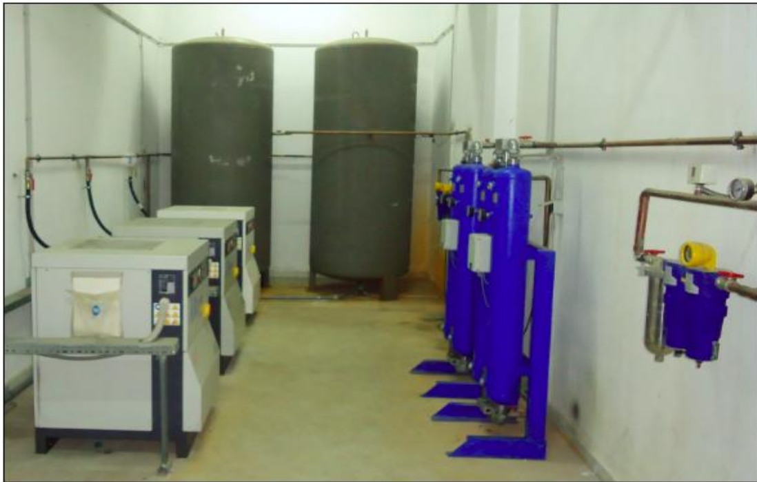
Εικόνα 3.3: Συστοιχίες φιαλών αέρα, αεροφυλάκια και ξηραντήρες
