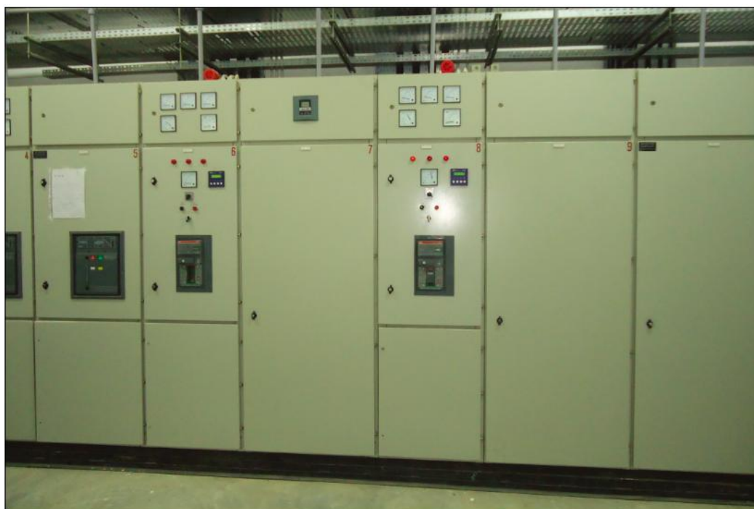
Εικόνα 4.6: Υποσταθμός χαμηλής τάσης
