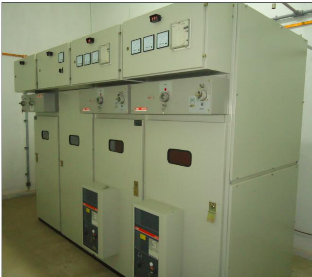
Εικόνα 4.5: Υποσταθμός μέσης τάσης
