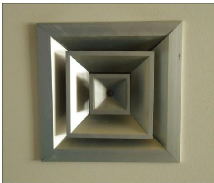
Εικόνα 6.14: Στόμιο προσαγωγής, απαγωγής θερμού-ψυχρού αέρα
