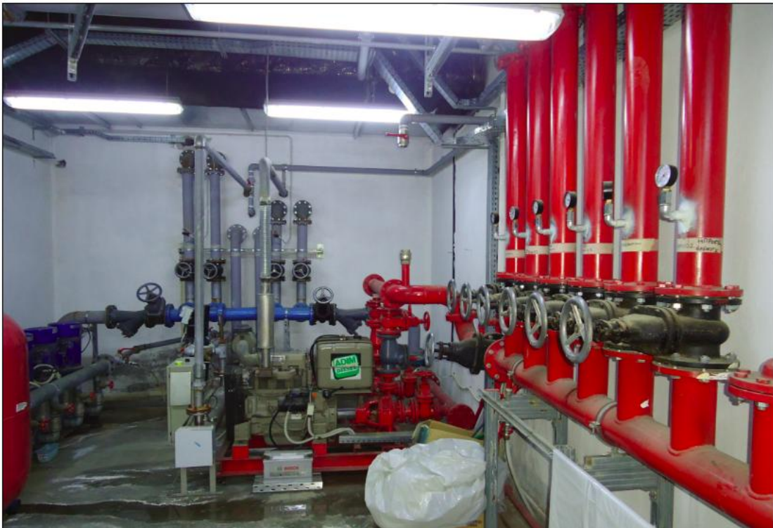
Εικόνα 5.3: Μόνιμο πυροσβεστικό συγκρότημα νερού
