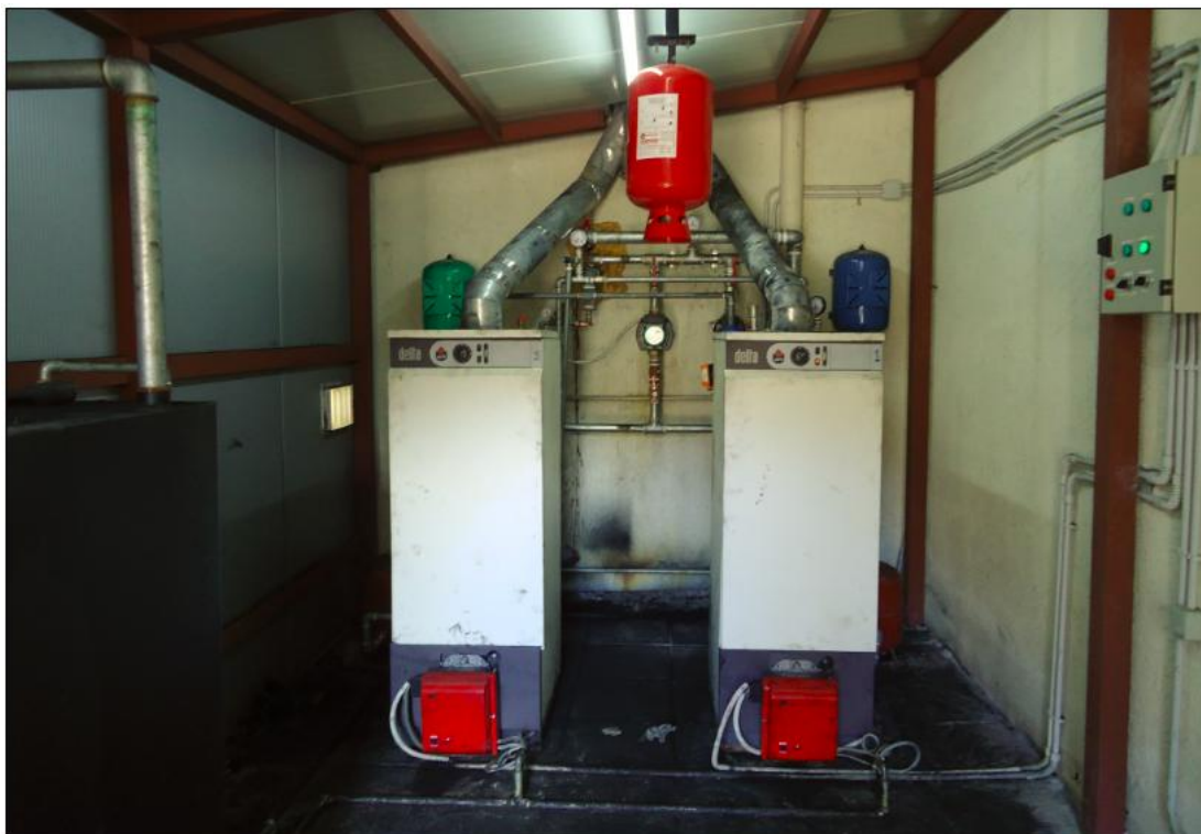
Εικόνα 6.8: Λέβητες ζεστού νερού χρήσης
