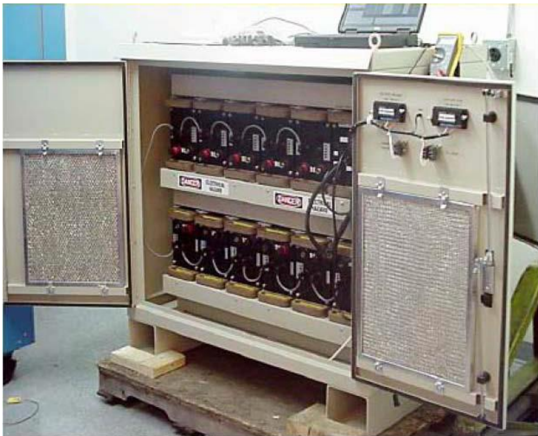
Σχήμα 1.11. Σύστημα ενεργειακής αποθήκευσης μπαταρίας ιόντος λιθίου των 100 kW. (Πηγή: Naishetal, 2006).
