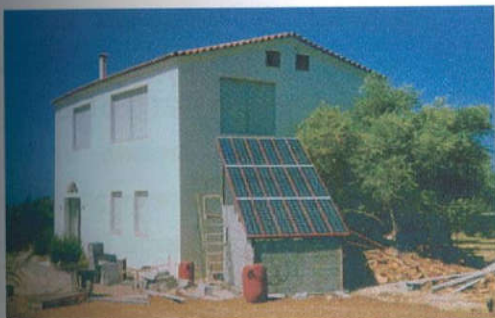
Αυτόνομο φωτοβολταϊκό σύστημα σε κατοικία μόνιμης διαμονής στο Ρέθυμνο Κρήτης.
