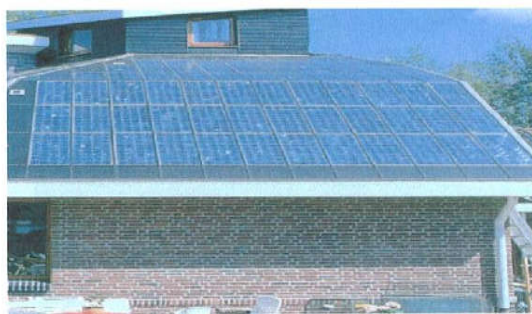
Φωτοβολταϊκό πλαίσιο σε στέγη κατοικίας στην Ολλανδία. Πηγή: Photovoltaics in buildings, 1996.
