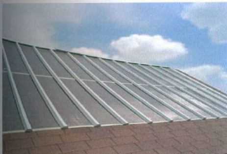
Φωτοβολταϊκό πλαίσιο σε κεκλιμένη στέγη κατοικίας. Πηγή: Parsons, Dave (NREEL).
