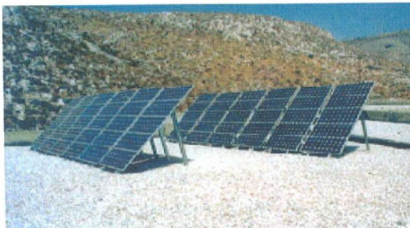
Εγκατάσταση φωτοβολταϊκού συστήματος στο 5 ο Γυμνάσιο Νίκαιας. Καλύπτει όλες τις ανάγκες του σχολείου και λειτουργεί παράλληλα με το δίκτυο της ΔΕΗ. Συνολική ισχύς 4,5 KW, 60 πλαίσια μονοκρυσταλλικού πυριτίου (75W το κάθε ένα), 6 ημιτονικούς αντιστροφείς για διασύνδεση με το δίκτυο. Συνολικό κόστος 15.000.000 δρχ.
