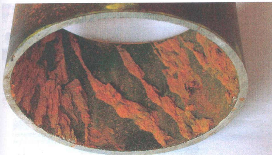
Σχήμα 5-2 . Διάβρωση λόγω της χαμηλής τιμής του pH και υψηλής περιεκτικότητας σε οξυγόνο στο εισερχόμενο νερό (Kristensen, 2002).
