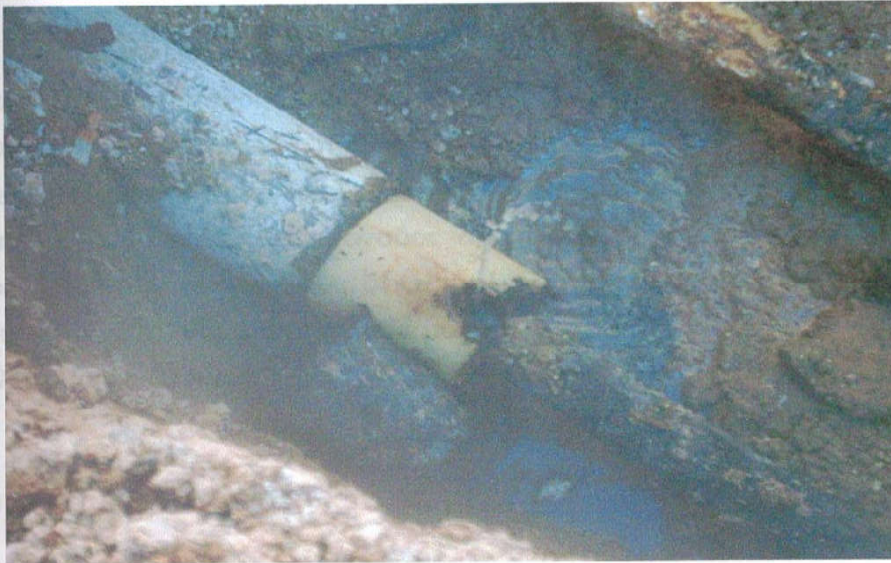
Σχήμα 5-7 . Διαβρωμένος σωλήνας ΔΕΥΑΚ (2004)
