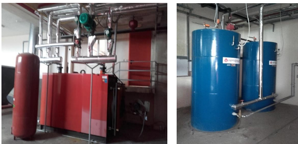
Σχήμα 4.6: γενική άποψη λεβητοστασίου (αριστερά) και μπόιλερ ZNX (δεξιά)
