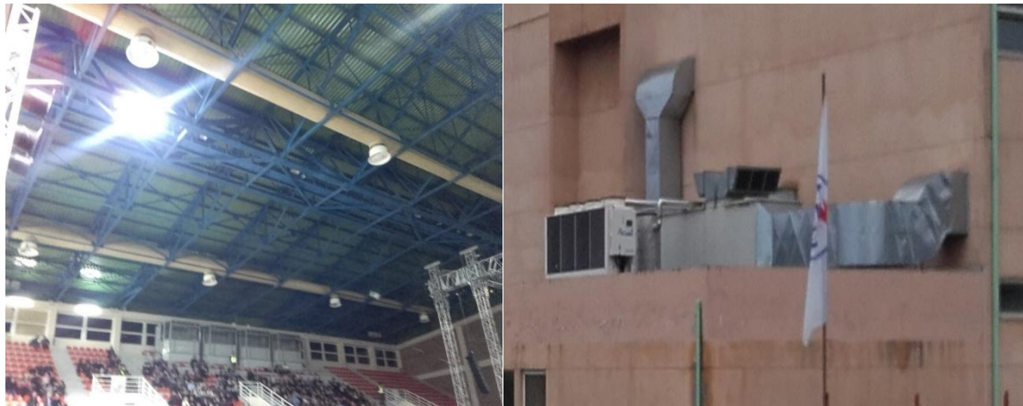
Σχήμα 4.4: Αεραγωγοί (αριστερά) και κλιματιστική μονάδα (δεξιά)
