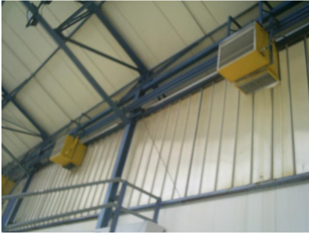
Εικόνα 7 – Μονάδες τύπου fan-coil
