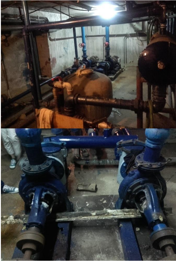
Εικόνα 8 – Μηχανολογικός εξοπλισμός επεξεργασίας νερού πισίνας
