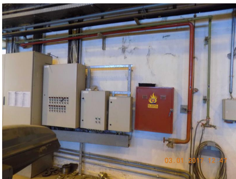
Εικόνα 34. Πυροσβεστική Φωλιά – Ασφαλισμένοι Πίνακες Ελέγχου
