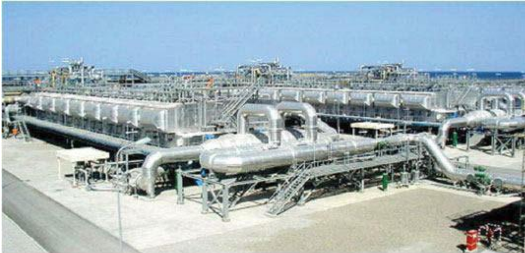
Εικόνα 3.1: Εγκατάσταση πολυβάθμιας εκτόνωσης στη Μέση Ανατολή
