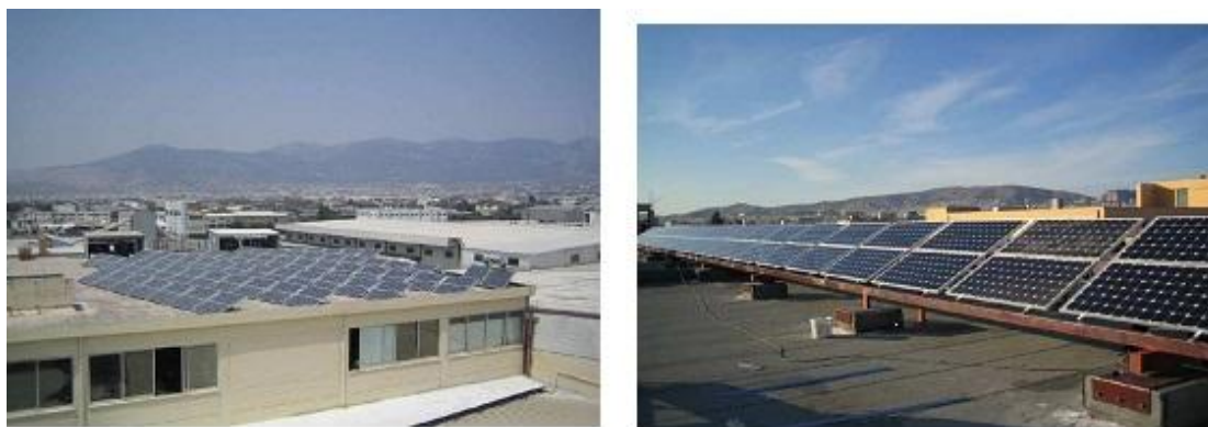
Εικόνα 2.4: φωτοβολταϊκά πάνελ σε οροφή βιομηχανικού κτιρίου
