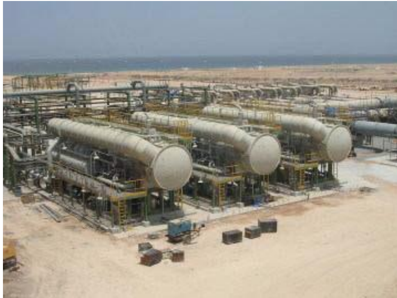
Εικόνα 3.3: Εγκατάσταση πολυβάθμιας εξάτμισης στο Ομάν (3 x 2400 m 3 /ημέρα)
