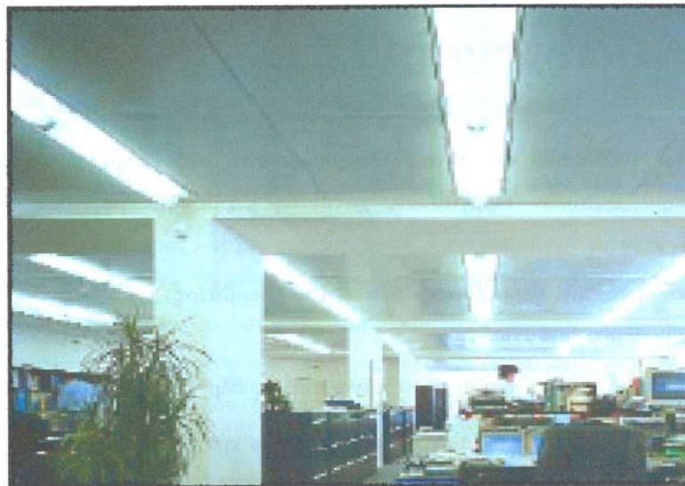
Σχήμα 7. Οι οροφές δροσισμού είναι κατάλληλες για χώρους όπου η αισθητή θερμότητα πρόκειται να απομακρυνθεί από τις κλιματιζόμενες περιοχές
